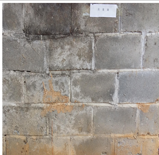
“开采项目”化粪池
