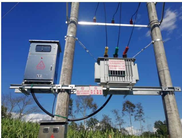
厂区供电设备
