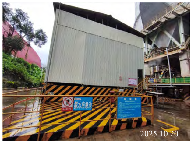
氨水储罐区及应急池
