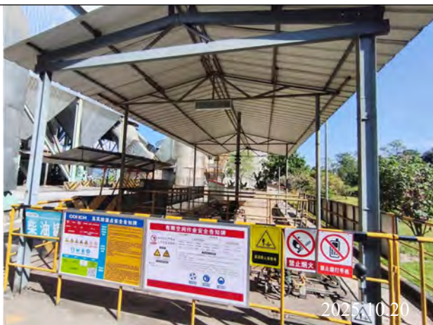
柴油储罐区及消防物资
