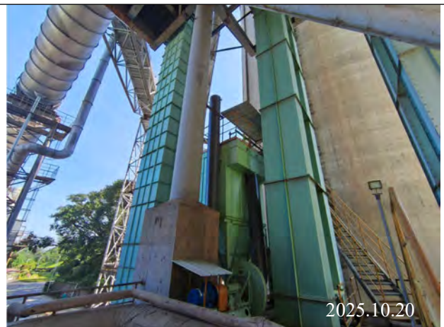
替代燃料斗提收尘排放口
