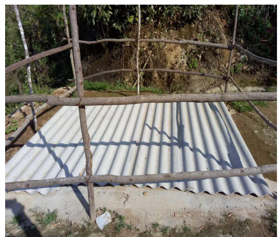
生活废水收集池
