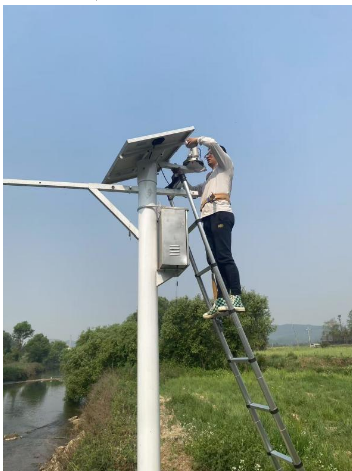
支那乡支那村自动水位雨量站
