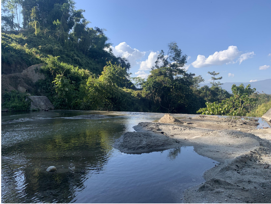
照片 6-13 南怀河 KC-19 拦砂坝淤积情况
